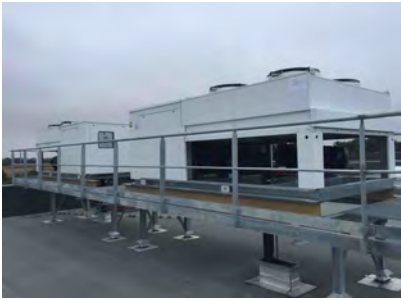
Les 2 groupes frigorifiques situés sur le toit, garantissent une production de froid optimale
