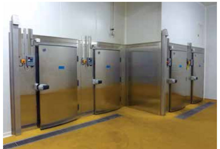
Les 4 cellules ACFRI (2 modèles CSP 6 et 2 CSP 10) implantées sur le nouveau site, permettent le refroidissement quotidien de 12 t de cakes par jour
